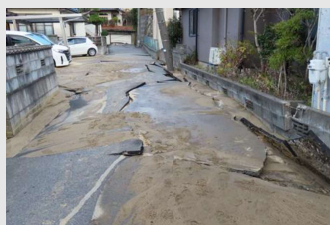
液状化被害（新潟県）
