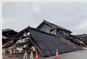
家屋倒壊（石川県）
