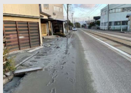
液状化被害（富山県）
