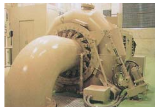
白中発電所内の横軸型発電機
