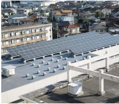
中央病院新東病棟 太陽光発電
