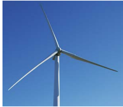
入善浄化センター風力発電施設
