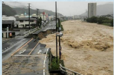
河川の決壊により崩落した国道2号線 (写真：国土交通省中国地方整備局)
