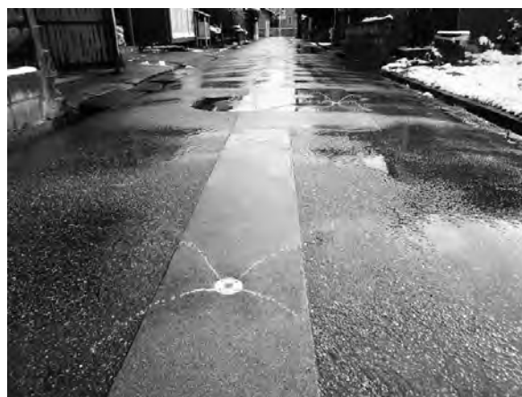
図2 道路消雪用設備の稼働状況（降雪時）
