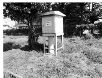
地下水位観測井
