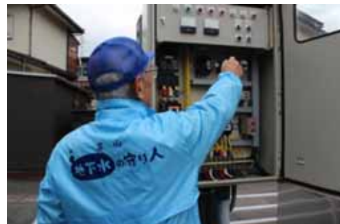
消雪設備の操作盤の調整
