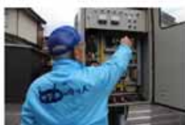
操作盤の調整
