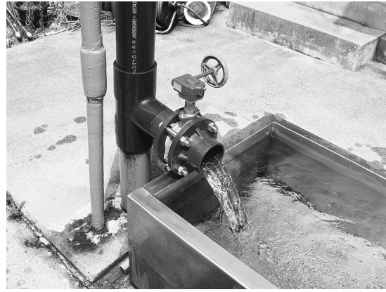
バルブを設置した自噴井戸
