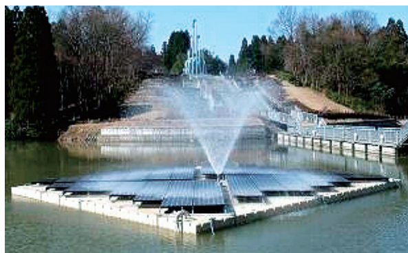
水上式太陽光発電システム（太閤山ランド）
