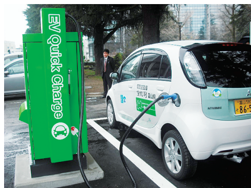
電気自動車急速充電ステーション（県庁）
