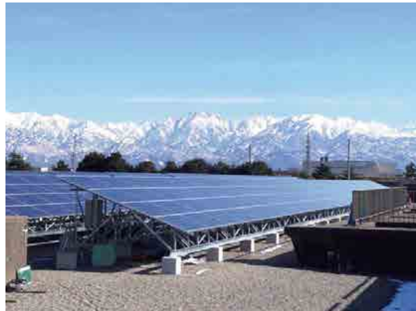
神通川浄水場太陽光発電所
