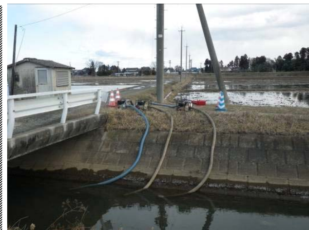
排水路からのポンプアップ
