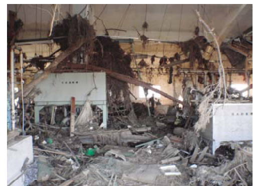
被災した農業集落排水施設
