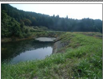
改修を待つ、大平池
