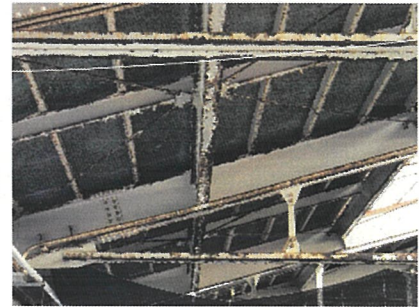
老朽化した施設の屋根
