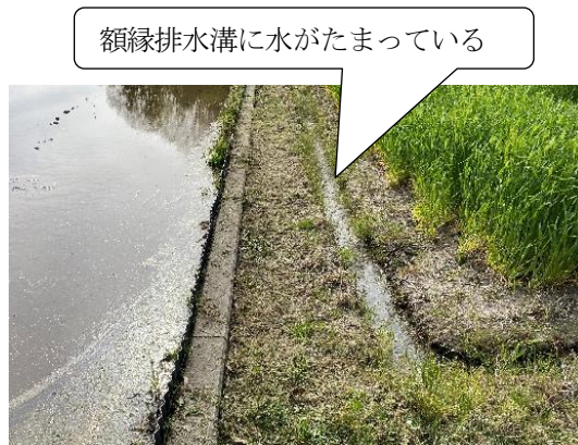
図5 隣接田から漏水しているほ場
