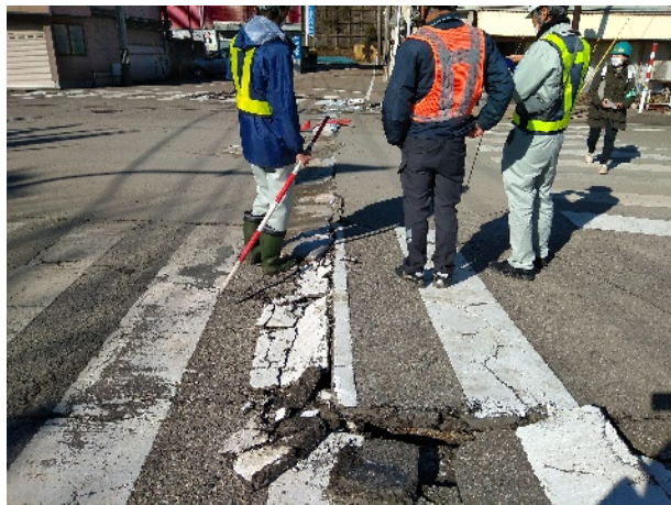
被災箇所での現地立会状況 (高岡市伏木地区)
