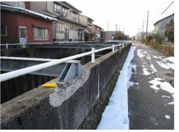
千保和田川の切梁破損状況（高岡市永楽町）
