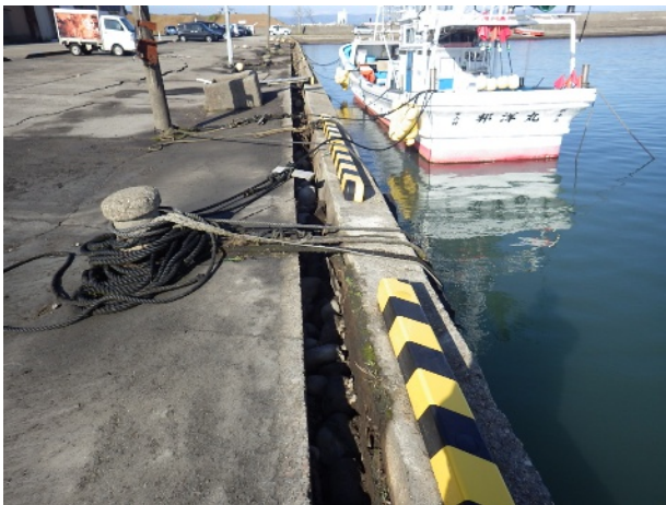
新湊漁港（岸壁の倒壊）
