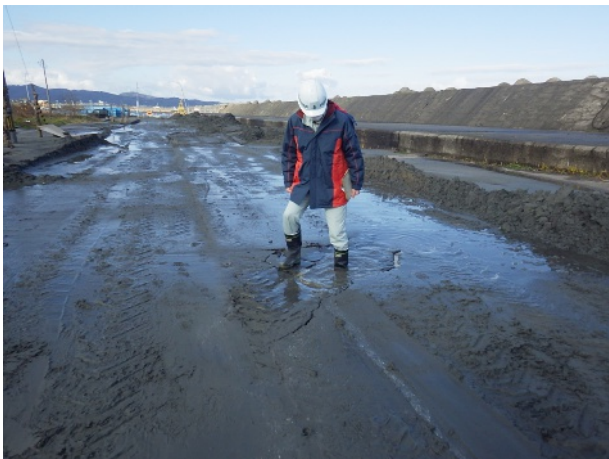
新湊漁港（液状化による土砂の噴出）
