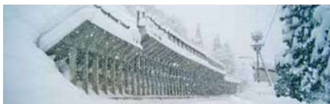
雪崩対策施設
