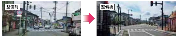
電線共同溝整備による無電柱化【県道高岡氷見線（高岡市木舟町地内）】
