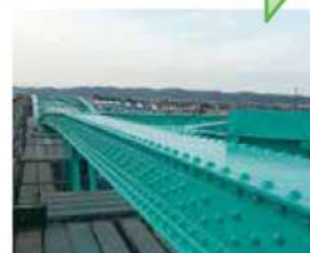
鋼橋の防食機能維持
