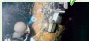
港湾岸壁の防食機能維持
