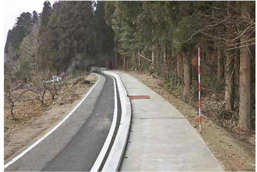
（株）花岡組施工の「用排水施設整備片貝川沿岸地区天神野用水路第9工区工事」
