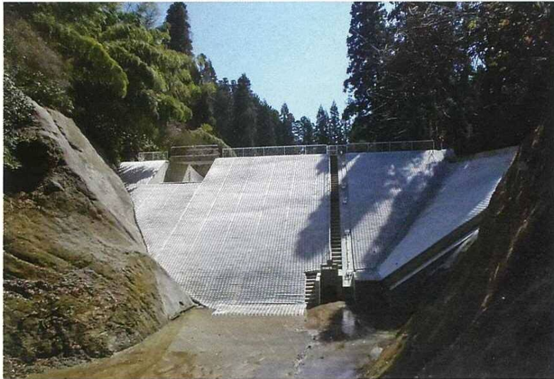
勢田建設(株)施工の「県営農村地域防災減災事業岩田池地区岩田池堤体改修工事」
