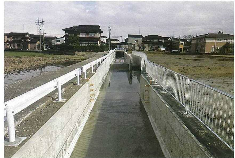
たち建設(株)施工の「農地防災庄川左岸三期地区西新又口用水路 第3工区整備工事」
