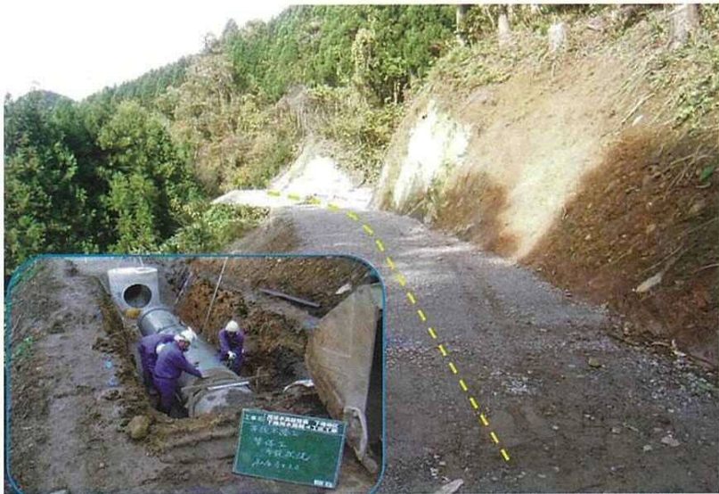
(株)河口組施工の「用排水施設整備下樁地区下樁用水路第4工区工事」
