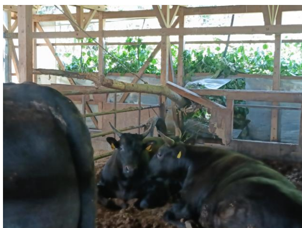
倒木や土砂による牛舎の損壊 (氷見市寺尾地内)
