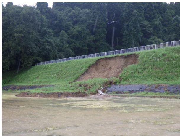
堤体法面が崩壊した農業用ため池 (氷見市七分一地内・西ヶ谷内池)
