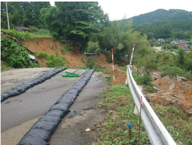
県道仏生寺太田線の道路損壊状況 (氷見市吉池地区)
