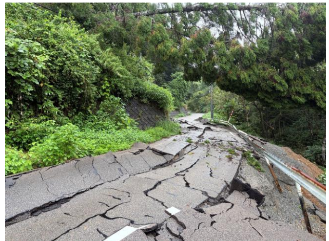
県道万尾脇方線の道路損壊状況 (氷見市味川地区)
