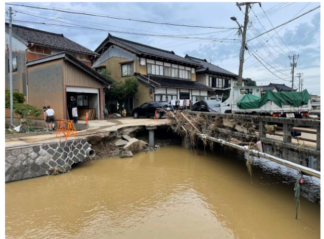
宇波川の護岸崩壊による被災状況 (氷見市脇方地区)
