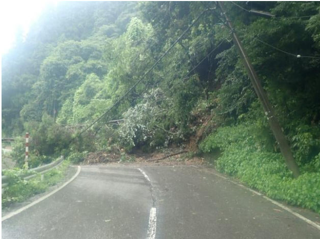
道路への土砂流入 (県道高岡氷見線(氷見市桑院))
