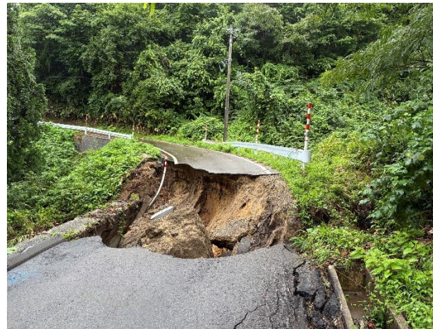
大雨による道路損壊 (県道鹿西氷見線(氷見市懸札))
