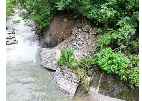
7月下旬の大雨により被災した護岸
