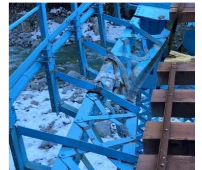
R6.1. 黒部峡谷鉄道 鐘釣橋 落石による被害
