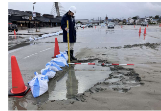
ひみ番屋街駐車場の液状化
