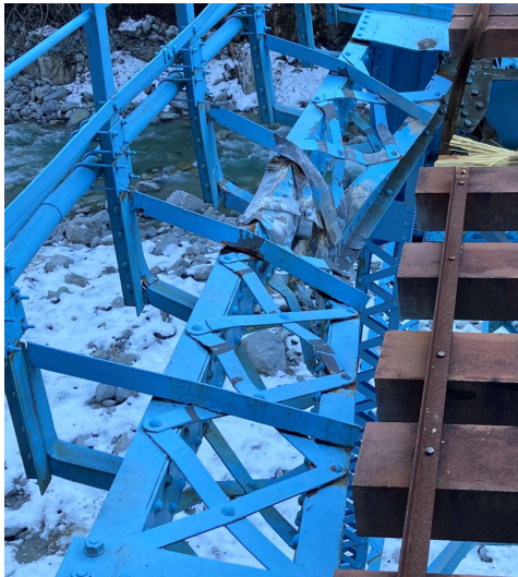
黒部峡谷鉄道 鐘釣橋 落石による被害
