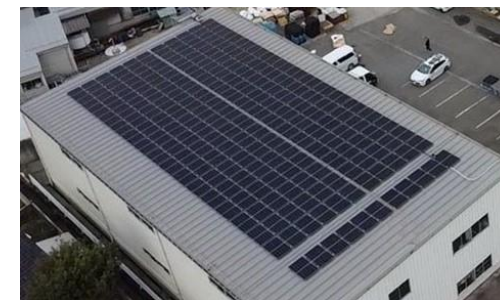
自家消費型太陽光発電設備
