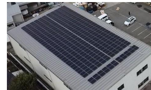
自家消費型太陽光発電設備
