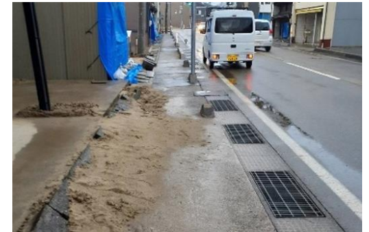
液状化の被害
