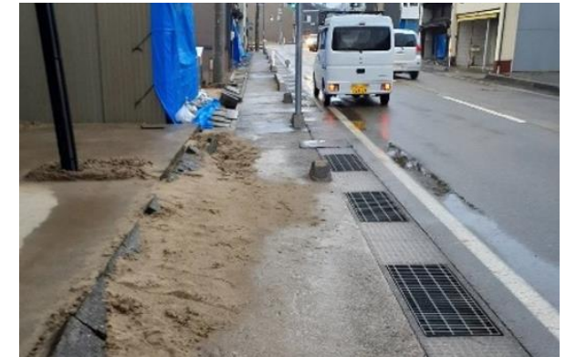
液状化の被害
