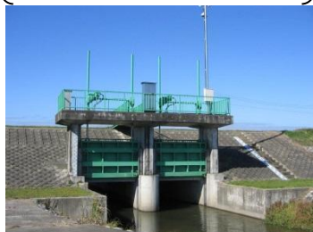
小矢部清水川樋門 (平成8年度設置)
