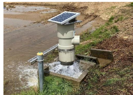
▲遠隔監視・操作が可能な ICT自動給水栓
