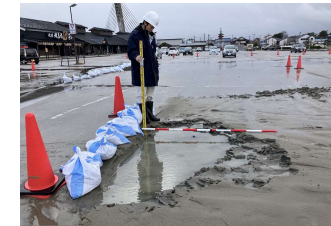
ひみ番屋街駐車場の液状化
