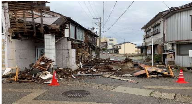
倒壊した家屋（氷見市）
