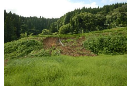
大雨により被災した道路・農地
