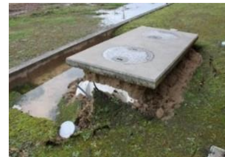
被災した浄化槽
