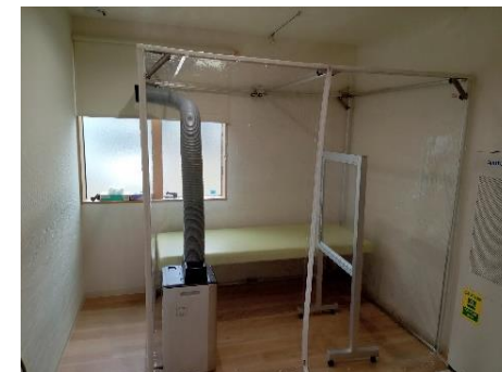
病室に設置した空気清浄機
