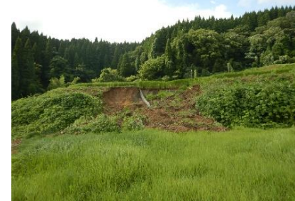
大雨により被災した道路・農地
