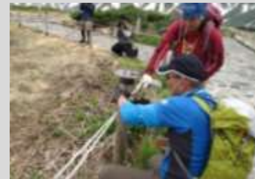
ライチョウ保護柵の設置
