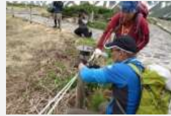
ライチョウ保護柵の設置
