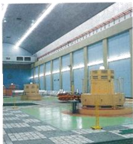
黒部川第四発電所
