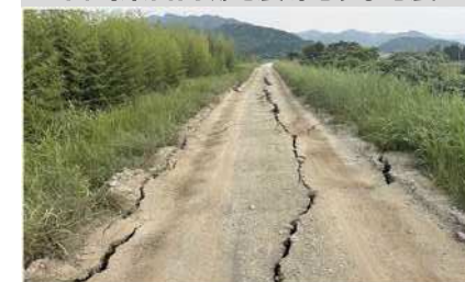
ひろた 広渡川水系広渡川の堤防天端の亀裂（宮崎県日向市）
