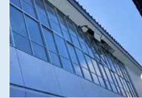
伏木高校（第1体育館） 軒天井落下
