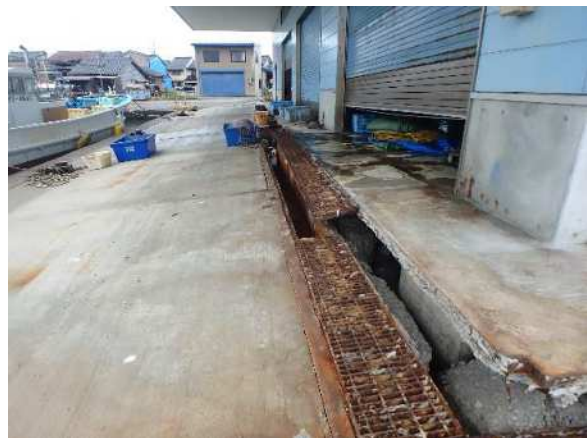
被災した荷捌き施設
