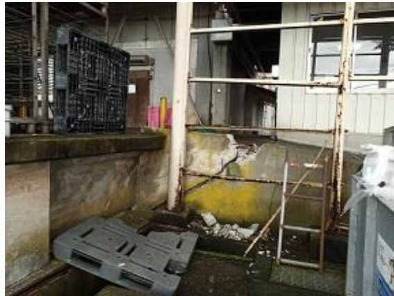
被災した水産業共同利用施設
