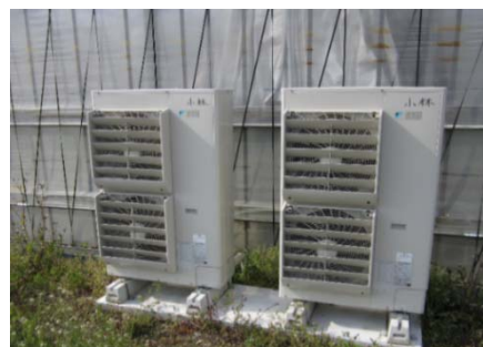
風向ガイドを取り付けた室外機
