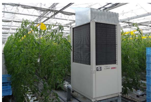
地下水熱源ヒートポンプ（室内機）
