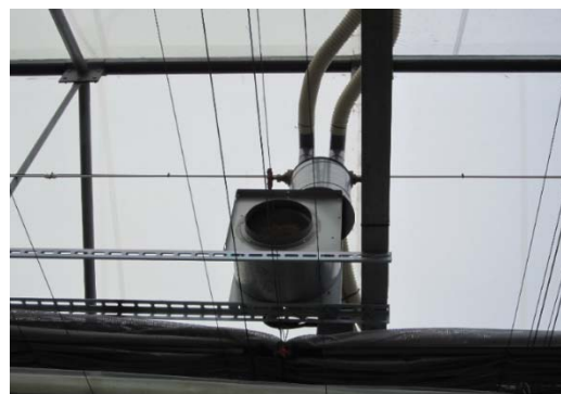
空気膜の加圧のための送風ファン
