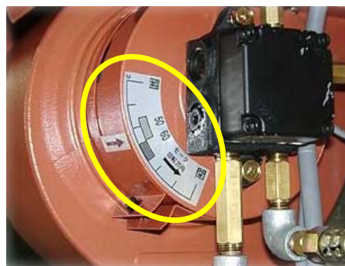
エアーシャッターの調整部
