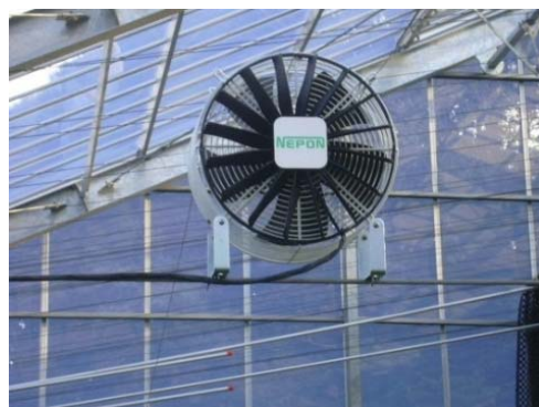
空気の流れをつくる循環扇
