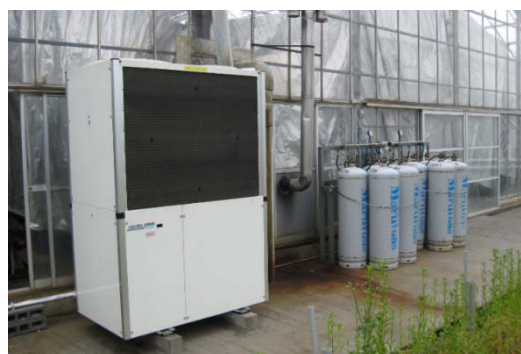
ガスヒートポンプ（室外機）
