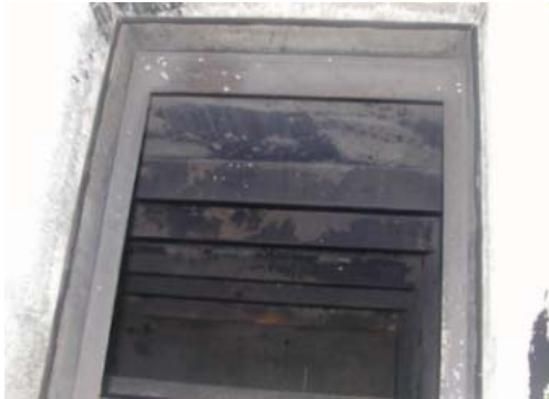
腐食抑制剤を使用している缶体
