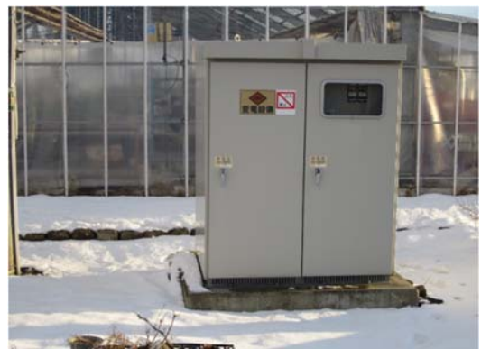
高圧受電設備（キュービクル）
