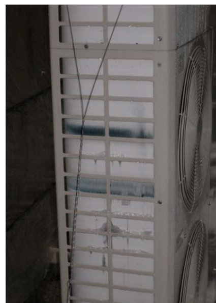
霜が付着した室外機
