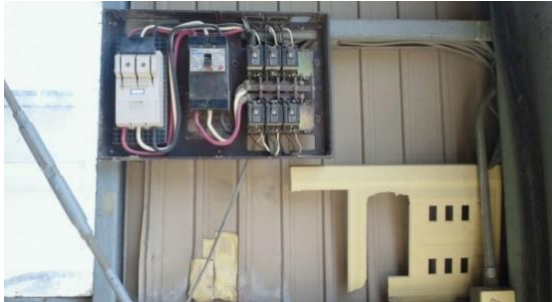
図1 配電器具の管理
