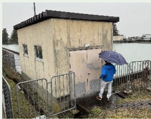
減圧弁室（ファームボンド）
