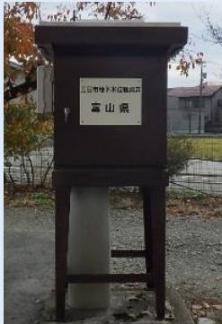
無線通信技術を活用して テレメータ化した観測井
