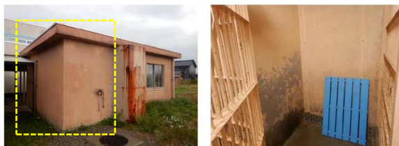
▲窓や空調がない犬舎 ▲排泄と食事の場所が近接
