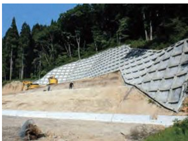
砂子谷災害復旧工事状況(令和7年6月時点)
