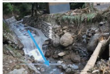
白岩川水系中谷川 被災状況
